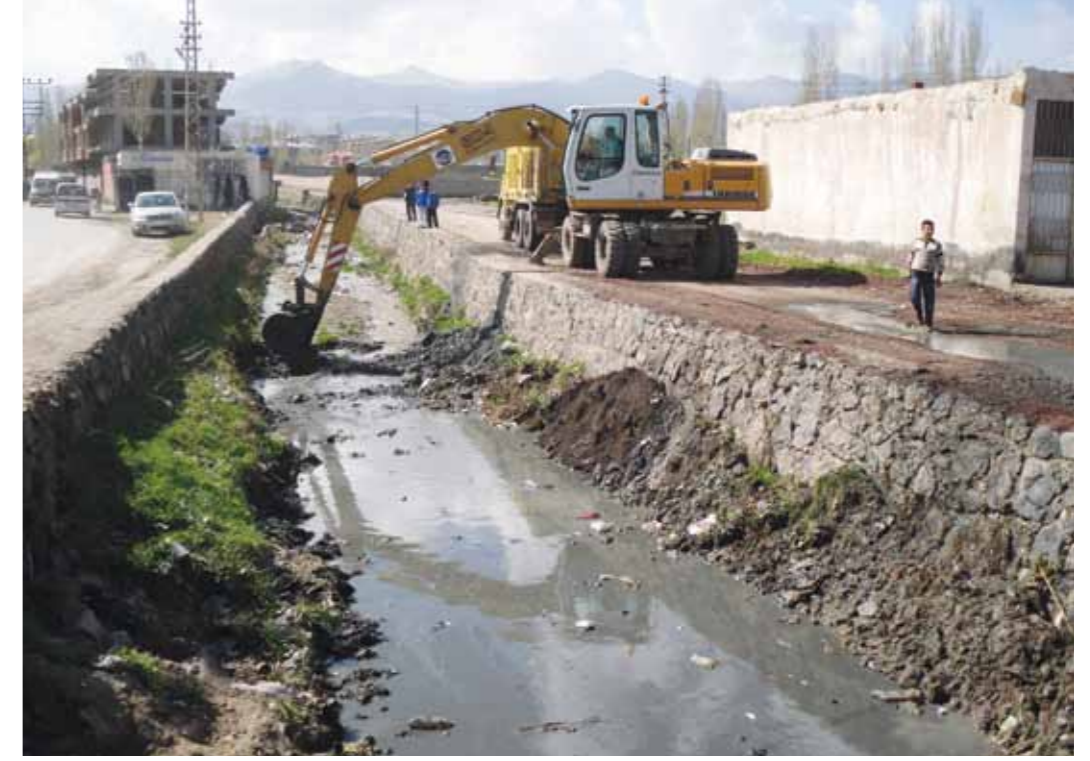
2.Nolu İğdır Caddesinden geçen Meryemana deresi güzargahında 413 m boyunda 5 mt. yüksekliğinde ve 2,70 mt. kalınlığında istinat duvarı yapımı gerçekleştirildi.
